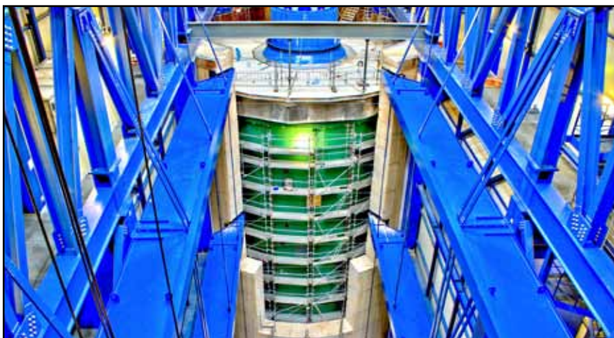
Der 26 Meter hohe und 2100 Tonnen schwere Reaktorbehälter wurde mit einer besonderen Art Leichtbeton verfüllt, damit im Inneren verbleibende Partikel bei einem Unglück während der Demontage nicht ins Freie gelangen können.
