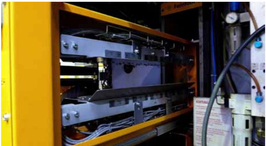
Die Sprühkammer enthält alle zur Versorgung der Band-Befettung notwendigen Leitungen und Anschlüsse für das Medium, Luftdruck und Elektrik.
